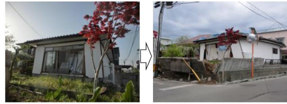
写真 6.2.1 建具を外れただけの住宅(左: 4/15)が大きな傾斜になった(右: 4/16)例
