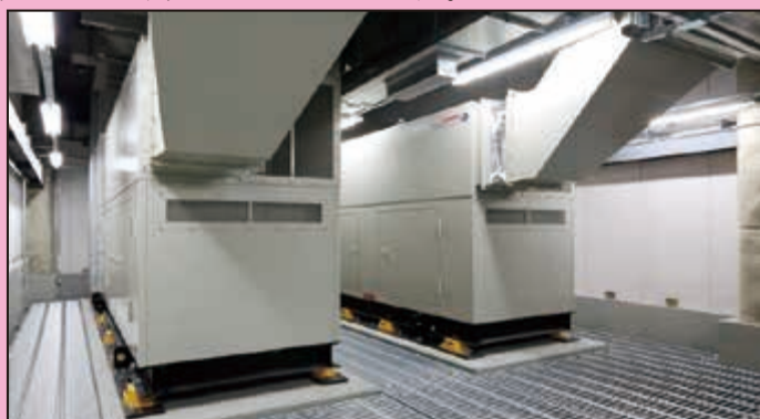
【エネセン棟 発電機室】
