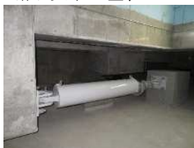
【基礎部のオイルダンパー】
