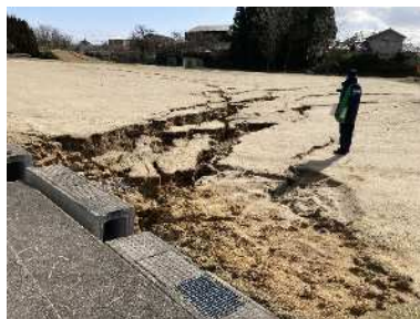
【建設候補地の地割れ状況】
